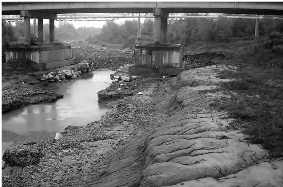
Figura 1.3. Intensa erosione lungo l'alveo del fiume Secchia a valle di Sassuolo.
